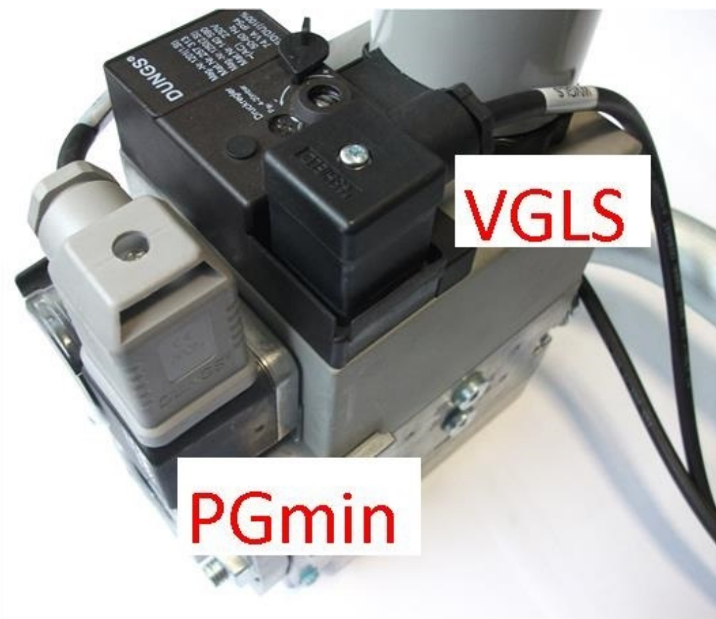
Электрические соединения к газовой магистрали
